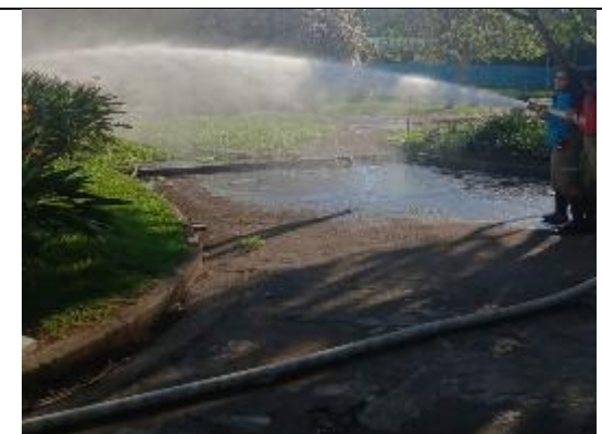
Figura 183: Teste preventivo do sistema de incêndio
