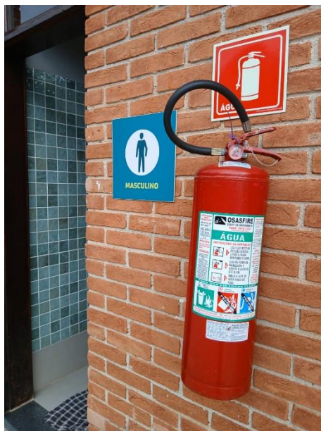
Figura 10 Exemplo de sinalização e presença de extintores
