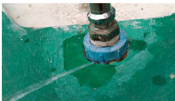
Figura 68: Manutenção de bebedouros
