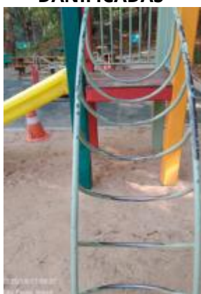
FIGURA 187 PINTURA DE PLAYGROUND (ANTES)
